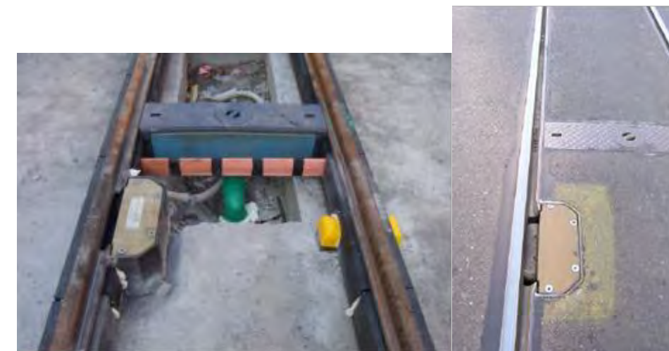
Figure 16 : Photos de compteurs d'essieux
