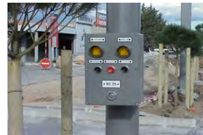
Figure 18 : Photo d'un boîtier de commande d'itinéraire à pied d'œuvre
