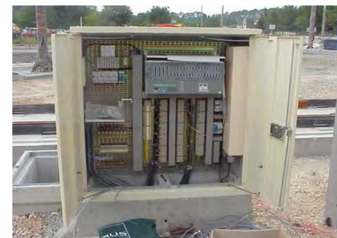
Figure 19 : Photo d'un coffret sur site
