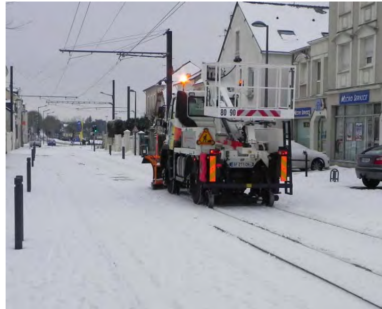
Figure 6 : Véhicule rail/route muni d'une nacelle et d'une charrue
